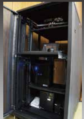
ラックの中に入った NOWing SERVER (下から 2 番目の棚)
