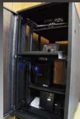
ラックの中に入った NOWing SERVER (下から 2 番目の棚)
