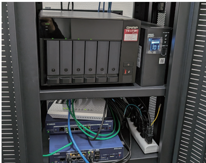
サーバーラックに設置されたAXEL-673A/24TB(QNAP TS-673A)
