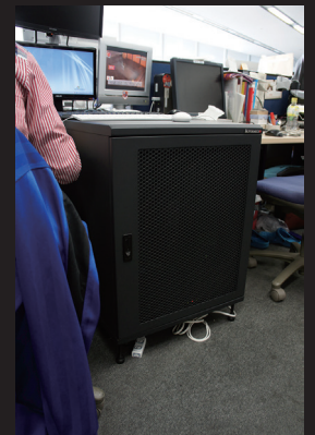
オフィスのデスク周りに設置されたサーバーラック。ラック内にタワー型サーバー、HDD、スイッチ、ケーブルなどが収納されている。
